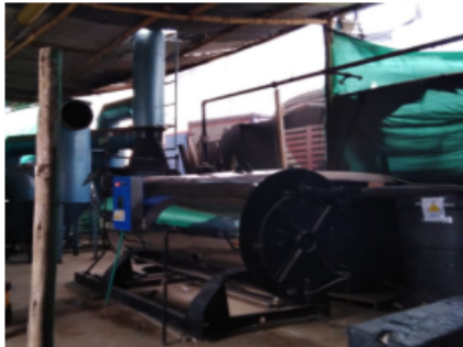
Fotografía 7: Caldera de 60 BHP
