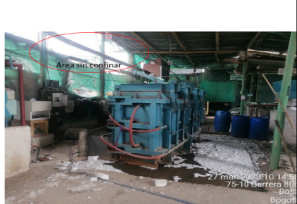
Fotografía No. 4. Ducto caldera Kewanee de 60 BHP que opera con gas natural..
